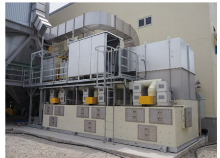
導入予定の省エネルギー設備(蓄熱式脱臭装置)： ナイツック工業(日本)
