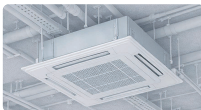
空調機器の冷媒ガス検知
