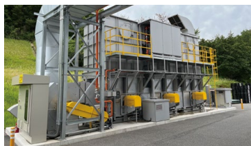
省エネルギー設備の導入（蓄熱式脱臭装置）： NISSHA インダストリーズ（日本）
